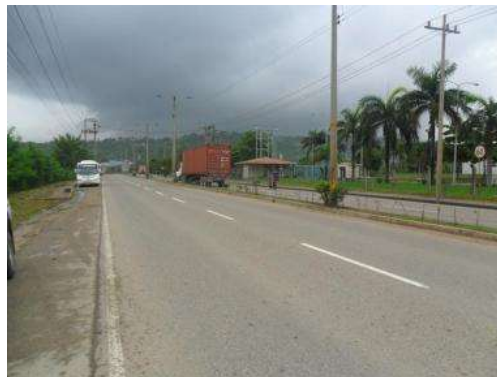
Fotografía 2.2 Aspecto general de la vía de doble calzada de dos carriles cada una
